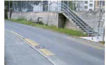
Fussgängerstreifen ist nicht mehr erkennbar.
